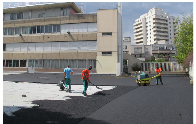
Rénovation de la cour de l'école Albert Cron, Le Kremlin-Bicêtre (94) – BET SECC
